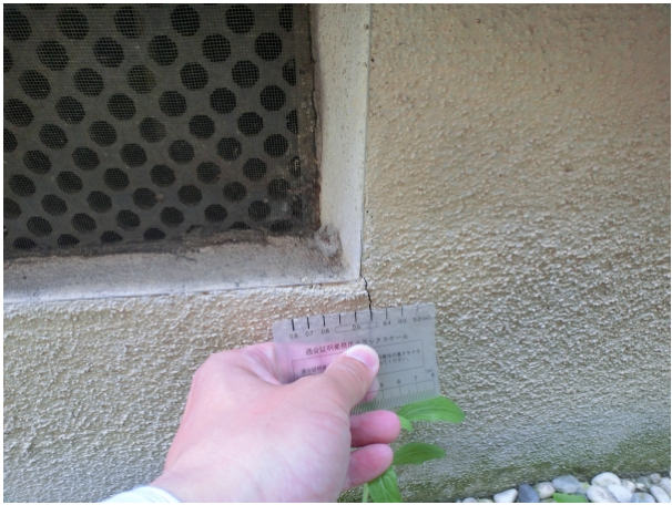
基礎 > 基礎表面 > モルタル仕上げ > 著しいひび割れ
