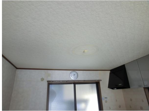
火災警報器 > 設置していない
