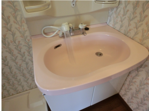
給水設備 > 著しい給水量不足
