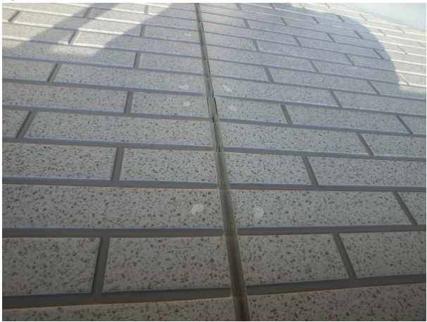
外壁仕上げ＞シーリング材＞シーリング材＞ひび割れ
