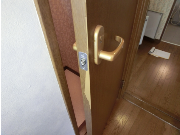
開口部 ＞ 室内ドア・引戸等 ＞ 室内ドア・引戸等 ＞ 動作不良
