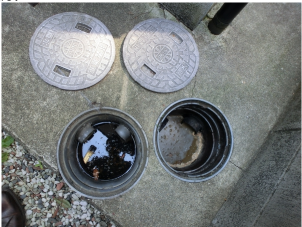
排水設備 ＞ 最終枡（敷地内）
