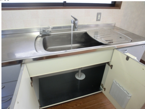
排水設備 ＞ 排水管（建物内）
