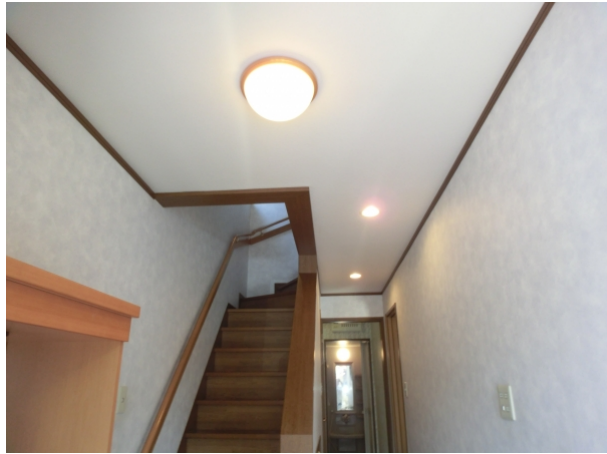
その他 ＞ 照明器具のある電灯の不点灯
