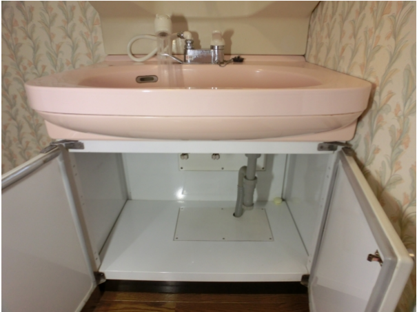
給水設備 > 漏水
