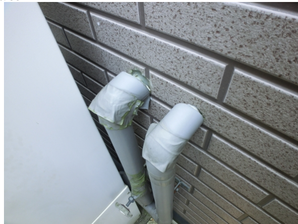
換気設備 > 外部貫通部 > 外部貫通部 > 給水管
