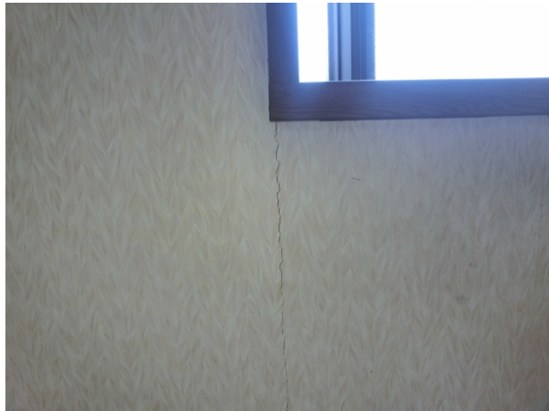
壁、柱および梁のうち屋内に面する部分 ＞ 仕上げ材表面 ＞ 壁紙等 ＞ 著しい割れ
