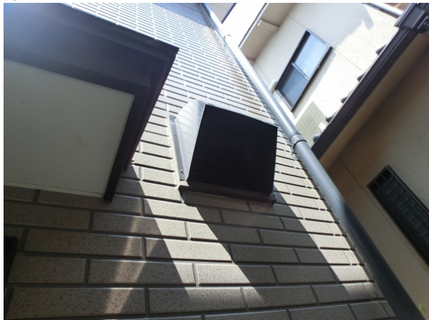
換気設備 > 外部貫通部
