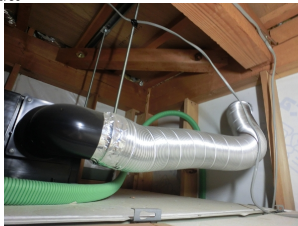
換気設備 > ダクト
