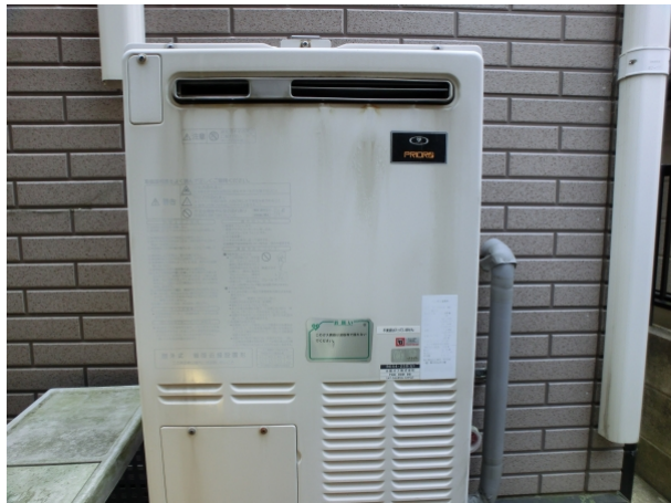
給湯設備 > 著しい給湯量不足
